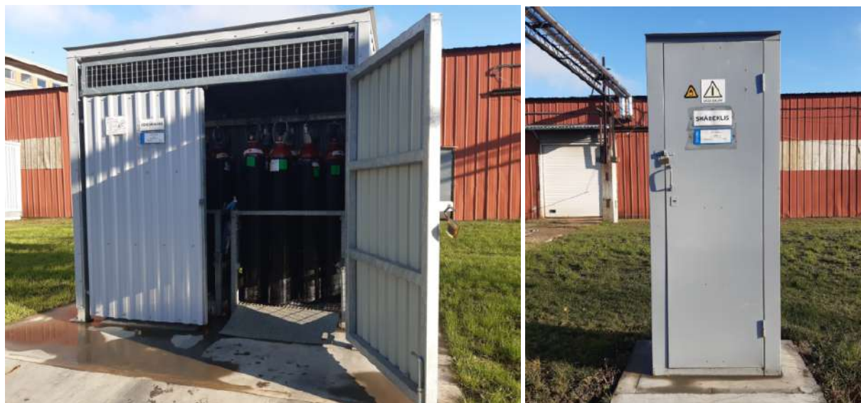
15.attēls. Degtspējīgas gāzes un oksidētājgāzes balonu nojumēs Figure 15. Flammable gas and oxidizer gas cylinder shelters
