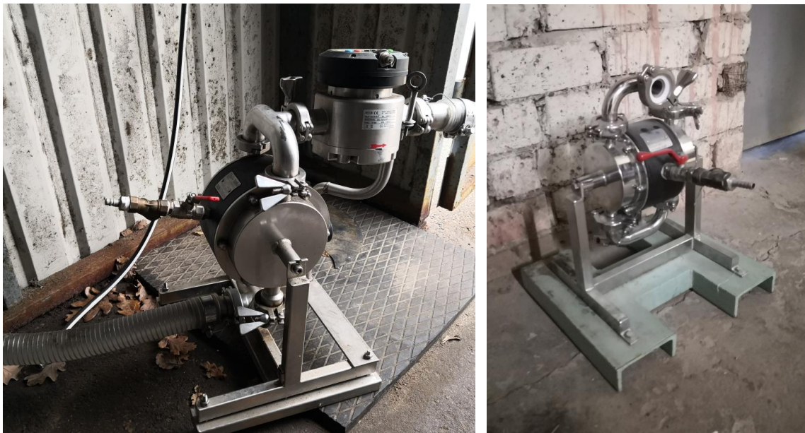
Portatīvais sūknis K3 korpusa nojumē un 1T7 telpā
