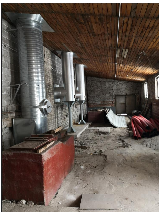
1.6.attēls. Apkures iekārtu dūmvadi.
