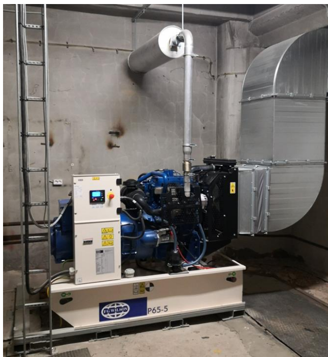
1.8.attēls. Dīzeļģenerators ar degvielas tvertni.
